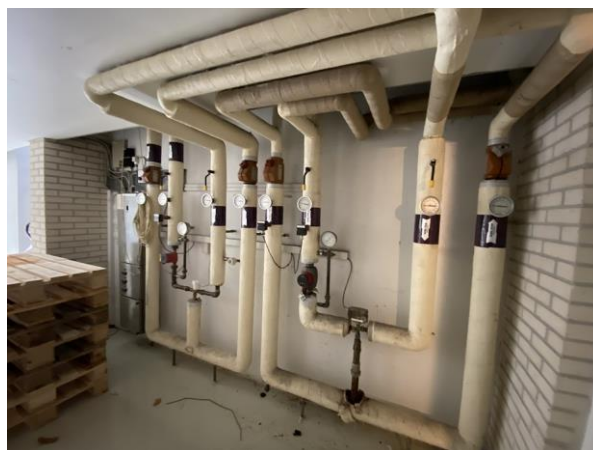
#32 Vandrør m. isolering og lærred.
